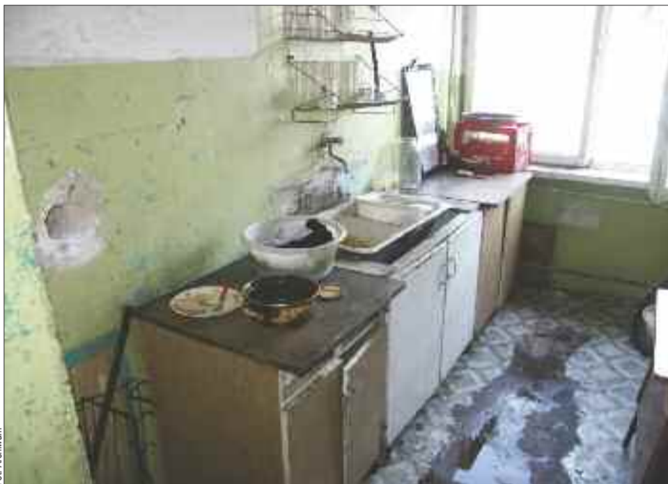
Wiele opuszczonych lokali mieszkalnych wymaga gruntownych remontów.
