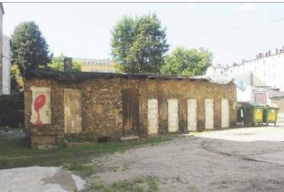
Brakuje pieniędzy na wyburzanie takich ruder, trzeba je więc zamurować, by nie doszło do jakiegoś nieszczęścia.
