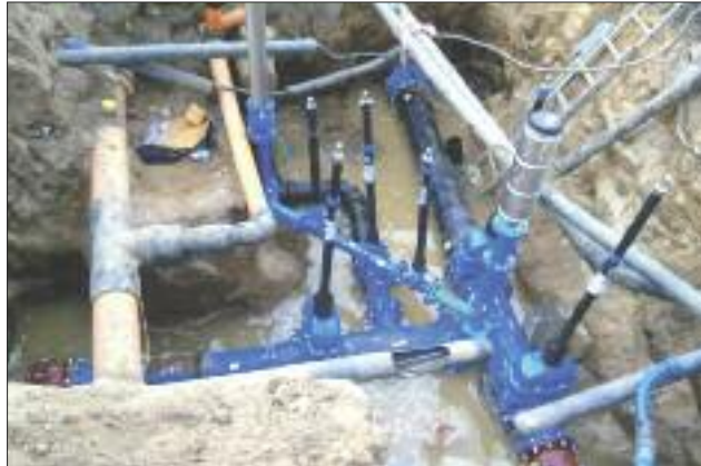
Najsłabszym elementem wieloletniej sieci wodociągowej są jej połączenia oraz armatura
