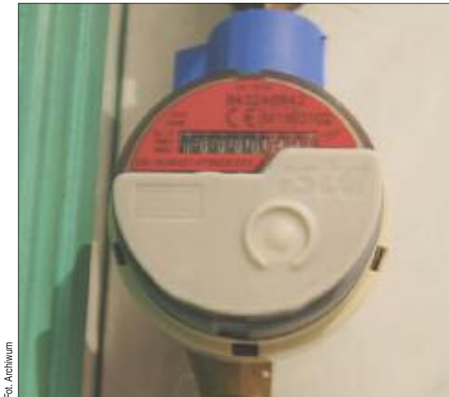
ZGM wymienia wodomierze na te nowego typu, które przekazują dane drogą radiową
