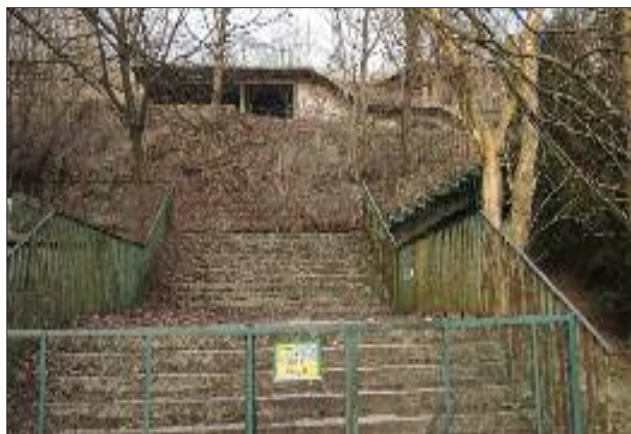
Tak wyglądają Schody Donikąd po 50 latach od ich wybudowania i 20 latach po zamknięciu
