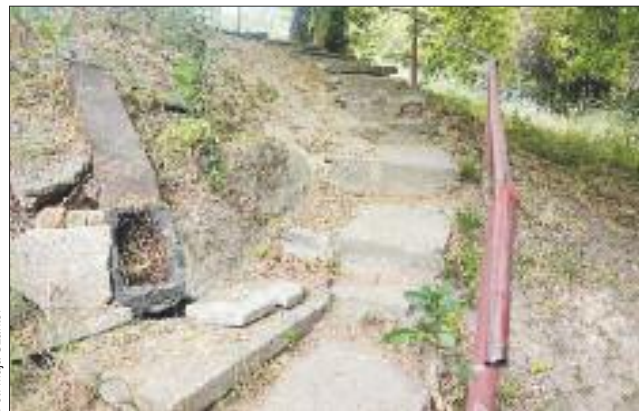
Mieszkańcy ulicy Gwiazdziej od lat czekają na remont schodów
