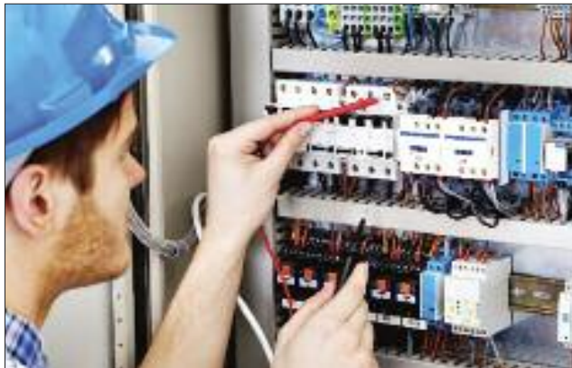
Instalacja zostanie całkowicie zmodernizowana
