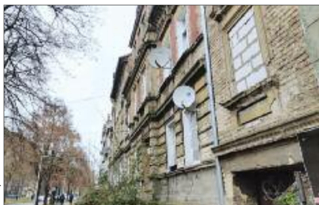
Kamienice przy ul. Kosynierów Gdyńskich w większości nigdy chyba nie przeszły generalnego remontu
